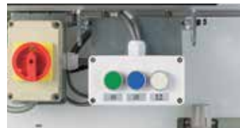
Interruptor de operación
