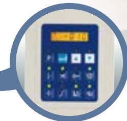
Panel de operaciones
